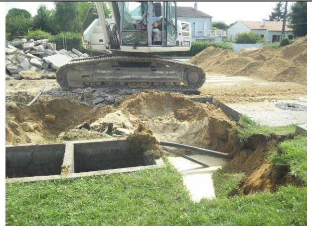
Rupture réseau AEP (magasin)
